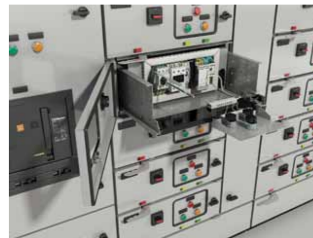
Figura 2 - Gaveta de um circuito de alimentação de um motor
